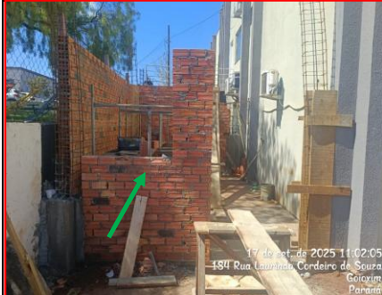
Detalhe Abertura Da Janela Sem Contraverga
