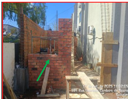
Detalhe Abertura Da Janela Sem Contraverga
