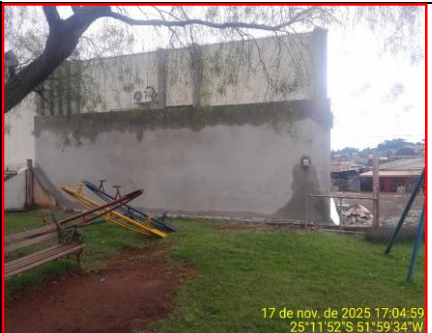
Detalhe Revestimento Da Parede Lateral
