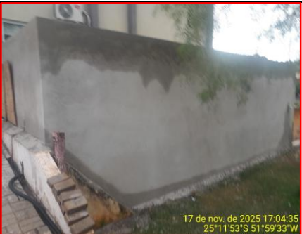
Detalhe Revestimento Da Parede Lateral
